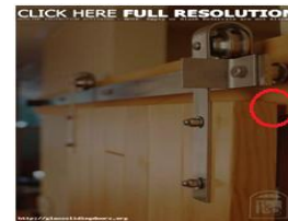
Gambar 2. Celah Pada Saat Pintu Tertutup 8
