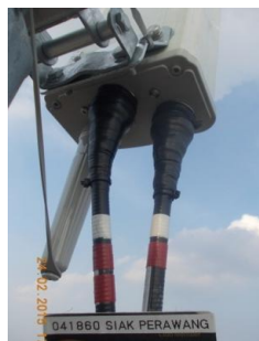
Gambar 12. Antena Sectoral yang Terpasang Kabel Feeder
