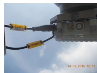
Gambar 16. ODU yang Terpasang Kabel Coaxial
