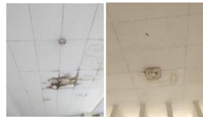
Gambar 3. Plafon yang rusak dan lampu yang sudah mati pada gedung E
