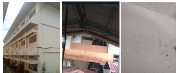
Gambar 4. Cat yang sudah terkelupas pada gedung E, G dan K
