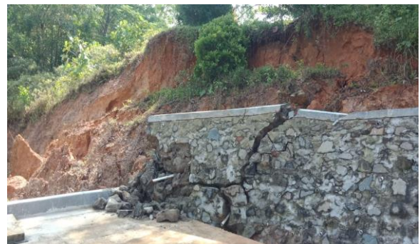
Gambar 1. Kegagalan dinding penahan tanah gravitasi
